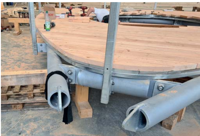
Bild 11: Für die Plattform kam eine kombinierte Stahl-Aluminium-Unterkonstruktion zum Zug, weil sie wartungsarm sein sollte. (Foto: Schaffitzel Holzindustrie)
